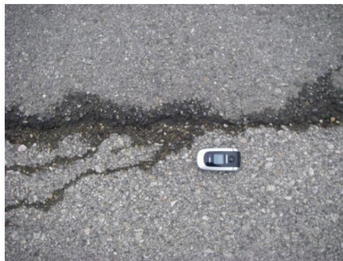
Otvorenie spoja - vznik prasklín a erózie.
