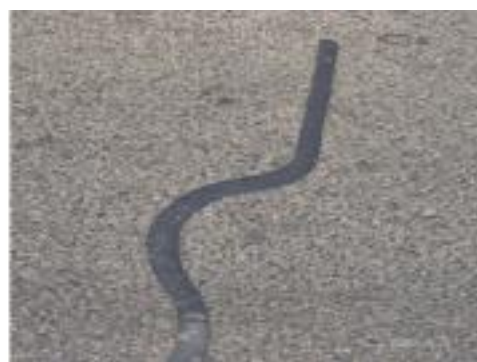
6. Výsledné zatlačenie a zapečatenie praskliny automobilovou premávkou.
