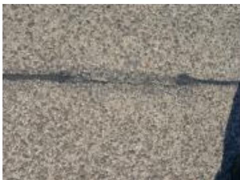
1. Prasklina asfaltového krytu vozovky sa nefrézuje.
