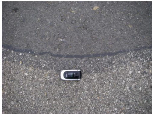
Flexibilný spoj starého a nového asfaltu.
