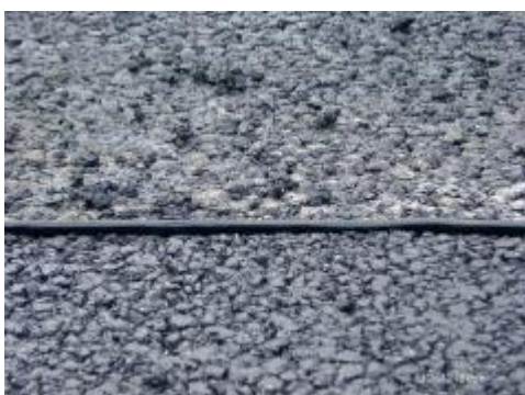
5. Teplom z asfaltovej zmesy sa páska nataví a previaže oba asfaltové koberce.
