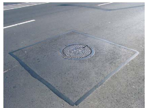
Použitie "studených" pásky DUNAFLEX 40x4 mm na uzavretie spojov v povrchu vozovky. Hore vertikálne použitie priamo do spoja výtlku. Dole dodatočne horizontálne na už zrealizované spoje, trhliny, praskliny a pod.
