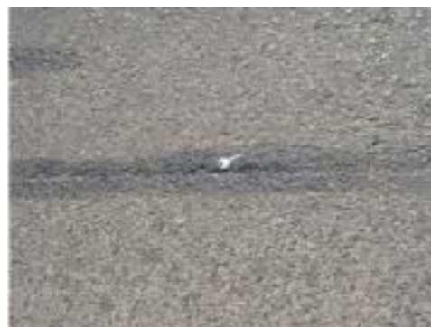
2. Penetrácia praskliny a okolia podľa potreby.
