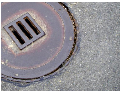
Bezzávadný spoj asfaltu a kovového rámu.
